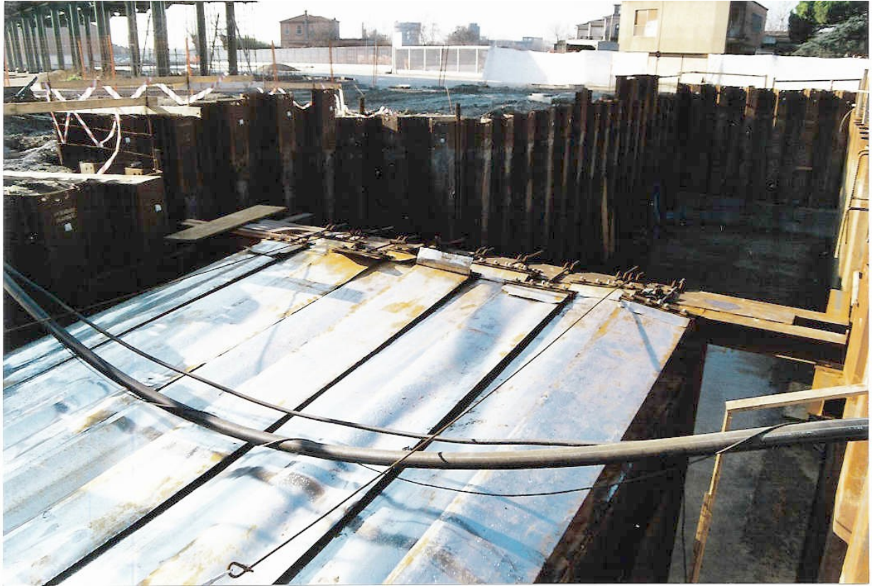
Vista della trincea di varo al termine della spinta del primo concio con il sistema dei nastri antitrascinamento UCS in primo piano
